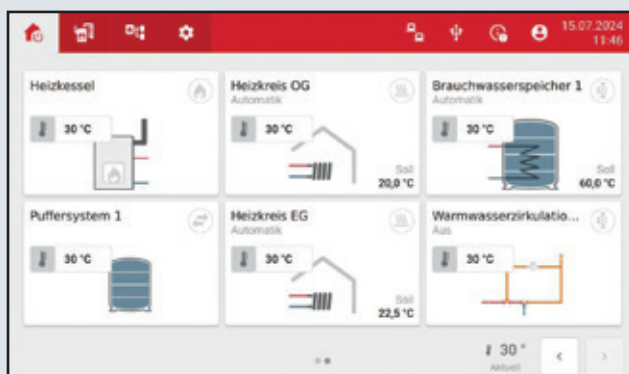
Übersicht der installierten Anlagen in Kacheldarstellung
